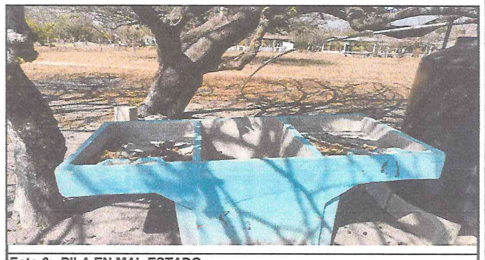
Foto 6: PILA EN MAL ESTADO
